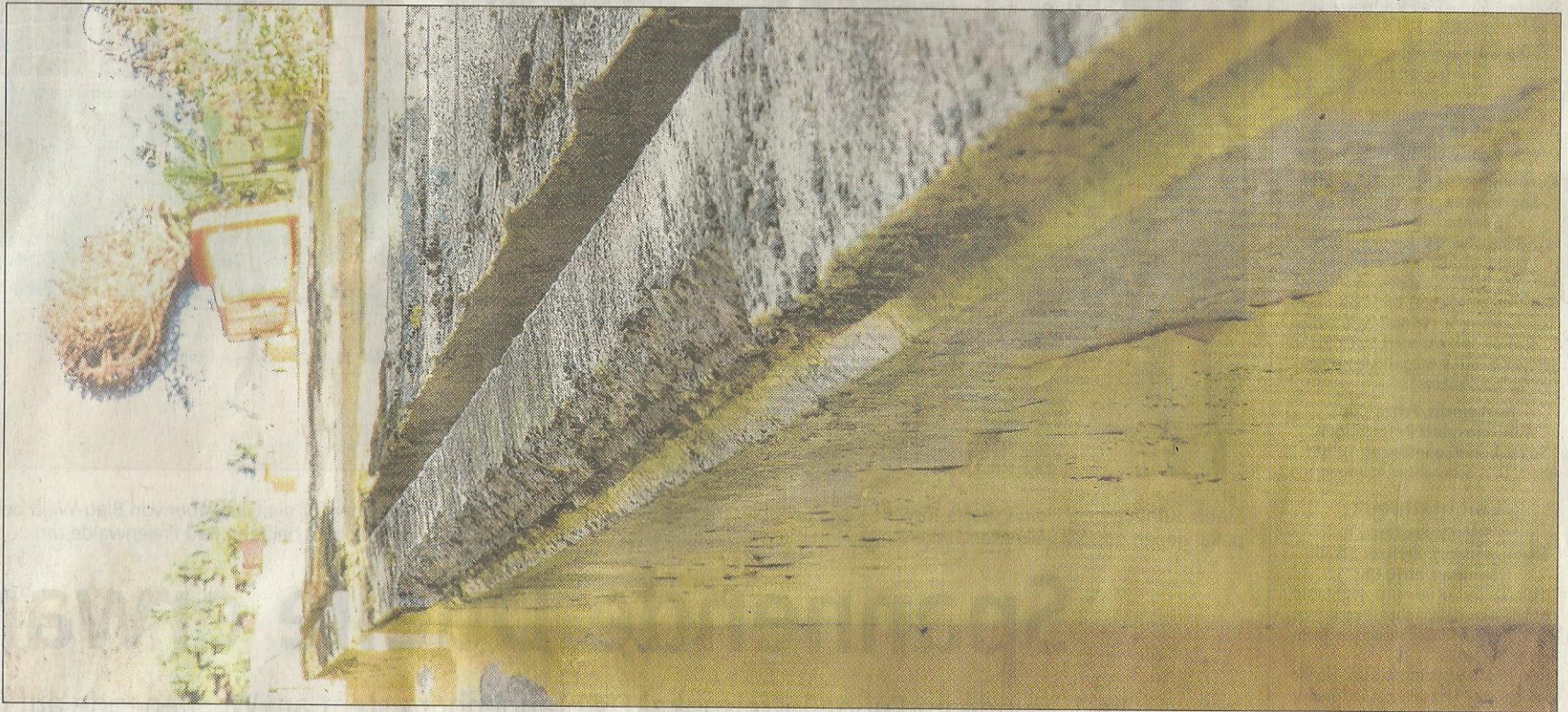
Schlimmer Anblick: Die Bestandsaufnahme ergab, dass der Beton morsch ist und ausbricht, die Moniereisen im Inneren rosten.
