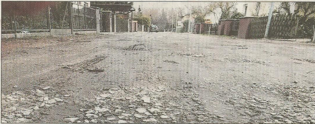
Schlagloch-Piste: die Scharnweberstraße in Erkner. Sie soll dieses Jahr als Erschließungsmaßnahme in einen zeitgemäßen Zustand versetzt werden.
